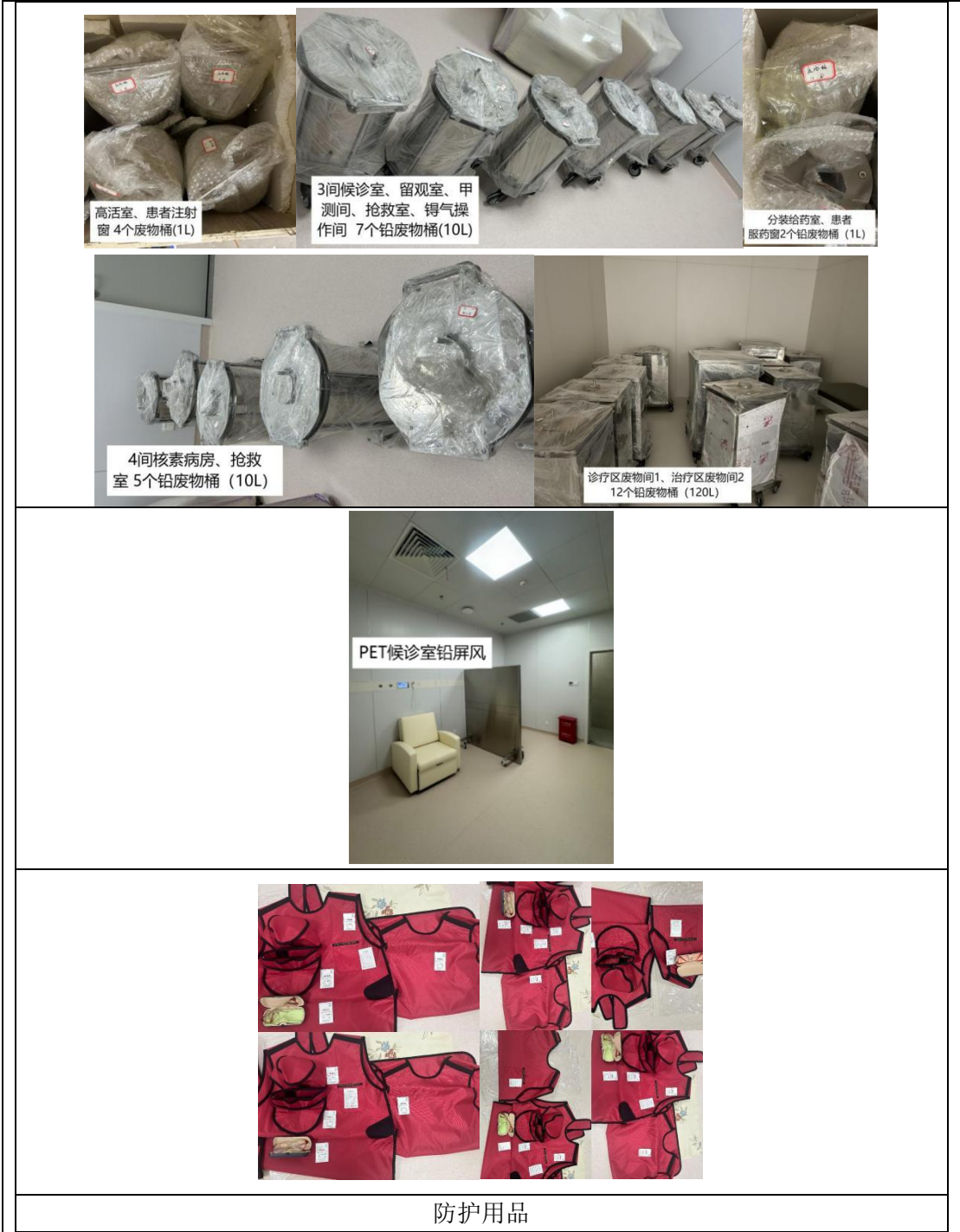
图 3-2 核素诊疗区 PET/CT 相关辐射工作场所配备的防护措施现场照片
